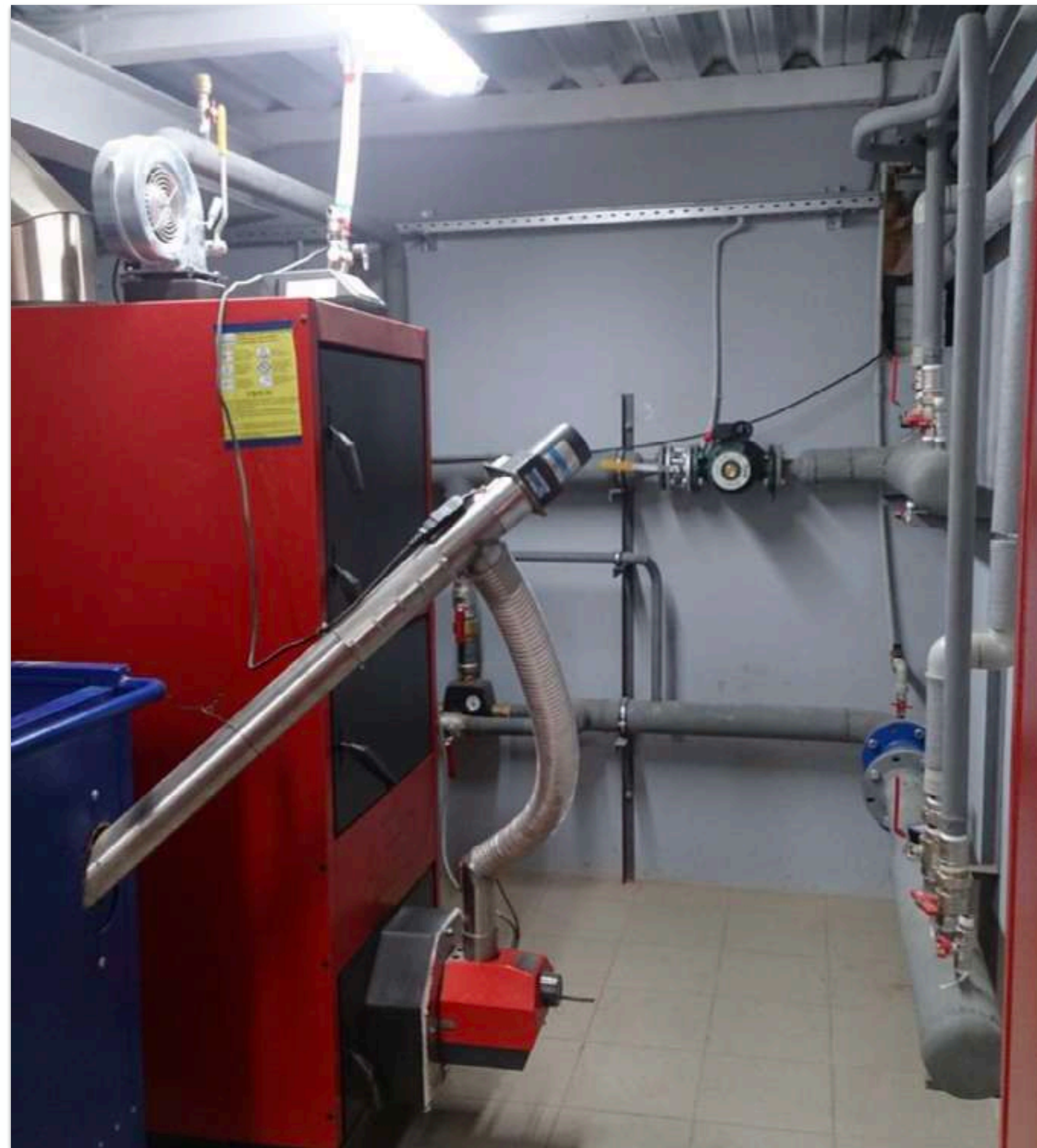
Котельня на базі універсального твердопаливного котла
